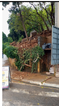
Vista da possível movimentação de massa.
