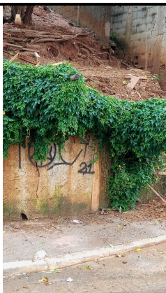
Vista da patologia visualizada.
