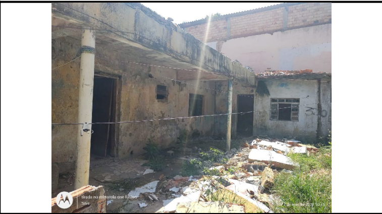
Local interdito e isolado
