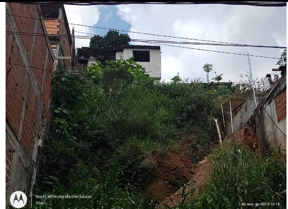
Talude de corte acima dos 70° graus
