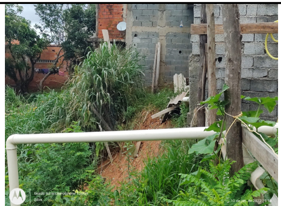
Ponto de início do deslizamento
