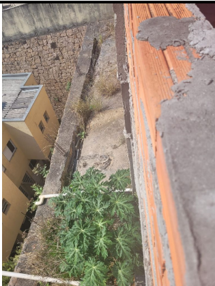
Muro de divisa com movimentação de massa
