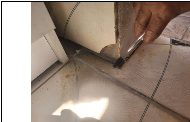
Trincas e rachaduras no piso.
