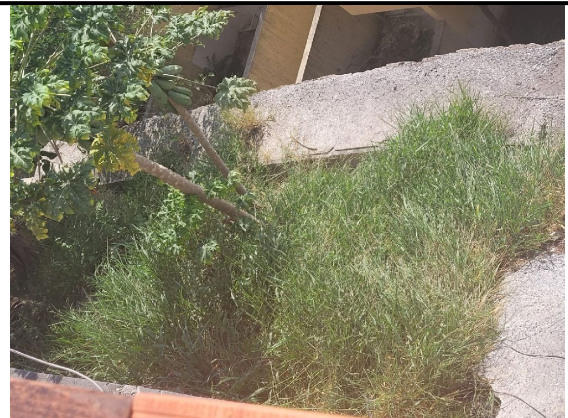
Muro com infiltração
