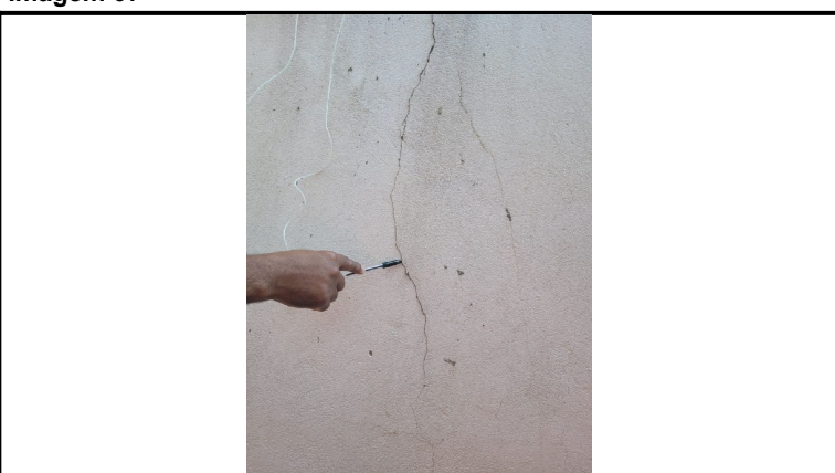
Trincas e rachaduras na parede.
