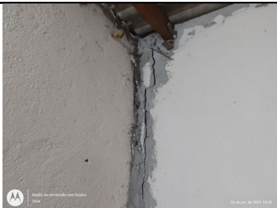
Trincas nas paredes
