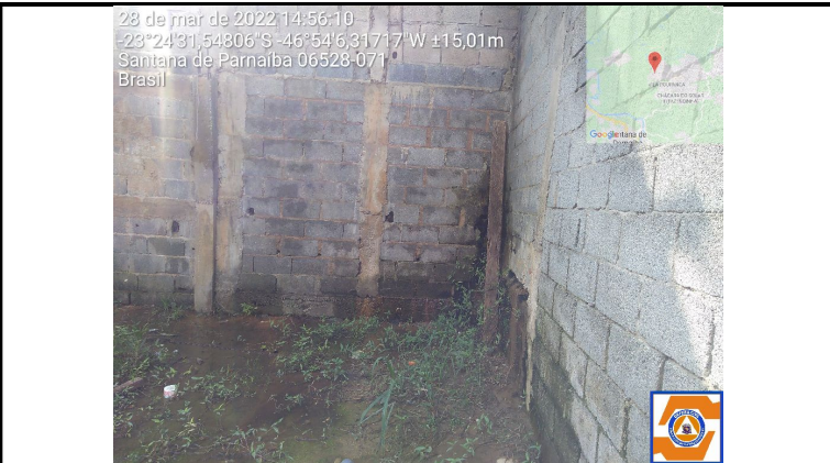
Muro com infiltração.
